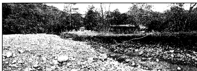
Fotografía No. 4. Brazo menor recostado contra el predio “Siberia 1”, facilitando la socavación sobre el terreno. Fuente: Autor 2021.
